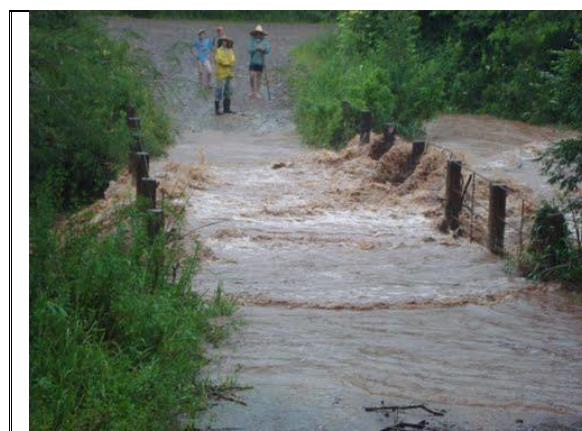
Figura 85. Ponte Putinga Baixa coberta pelas águas em período de chuva intensa.
