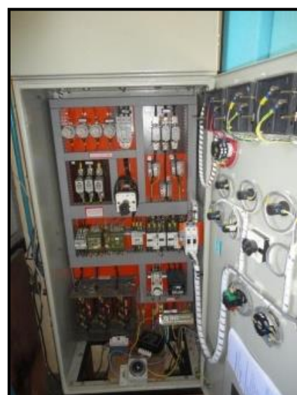
Figura 17. Vista do quadro de comandos, em perfeito estado de conservação.
