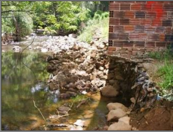
Figura 76. Edificação construída as margens do canal do Arroio Putinga.
