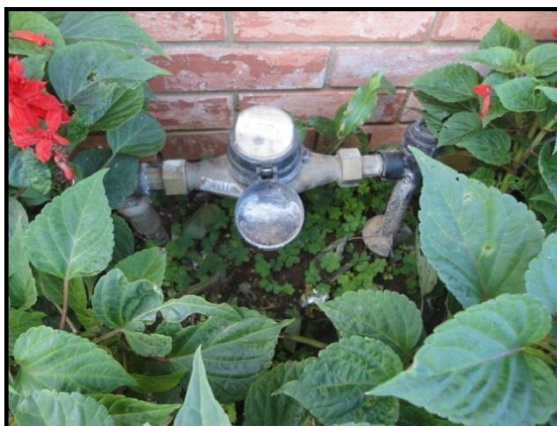
Figura 29. Hidrômetro de micromedição.
