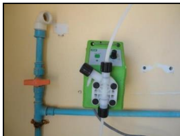
Figura 19. Detalhe da bomba dosadora.
