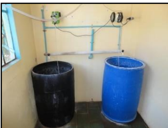
Figura 18. Vista interna da casa de química, com bombonas com produtos a serem dosados na água.
