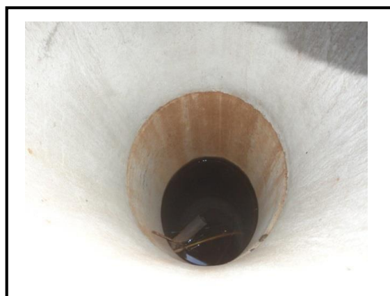
Figura 32. Vista interna do poço - SAC do Loteamento Mezomo.
