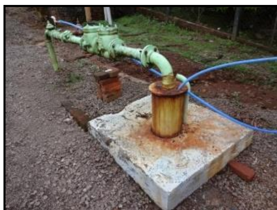
Figura 15. Poço de captação da água, com a devida proteção sanitária.
