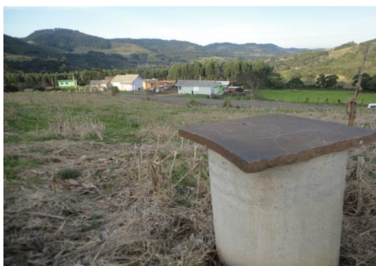
Figura 31. Captação precária através de poço raso - SAC do Loteamento Mezomo.
