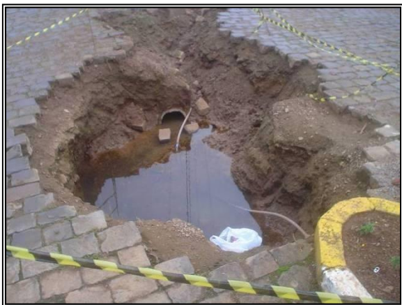
Figura 70. Tubulações do sistema de microdrenagem entupidas com sedimentos.
