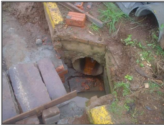
Figura 66. Tubulações de concreto existentes no sistema de microdrenagem.
