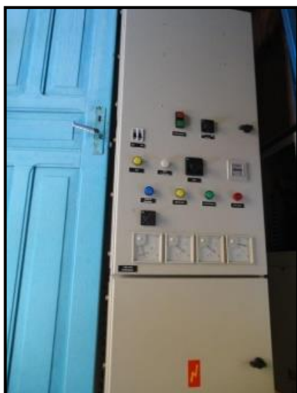
Figura 16. Vista externa do quadro de comandos.
