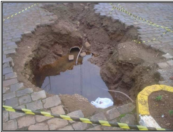
Figura 74. Tubulações do sistema de microdrenagem entupidas com sedimentos.
