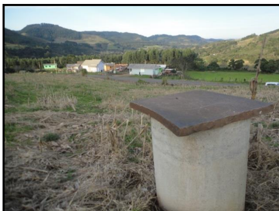
Figura 31. Captação precária através de poço raso - SAC do Loteamento Mezomo.
