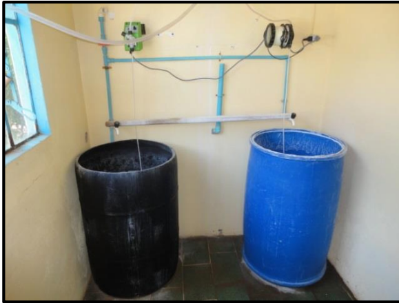
Figura 18. Vista interna da casa de química, com a bombonas com produtos a serem dosados na água. Fonte: BSW (2013).
