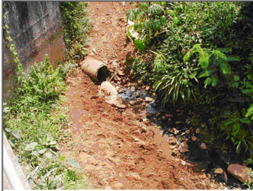
Figura 79. Conexão da tubulação de macrodrenagem em um pequeno córrego, com evidências de ligações clandestinas de esgoto doméstico.
