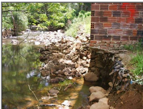
Figura 80. Edificação construída as margens do canal do Arroio Putinga.
