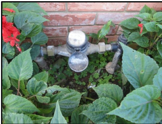
Figura 29. Hidrômetro de micromedição. Fonte: BSW (2013).
