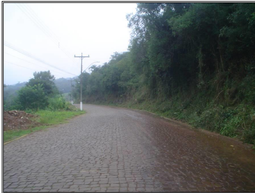
Figura 78. Exemplo de rua existente na sede municipal que não apresenta sistema de microdrenagem (Rua Julio de Castilhos).
