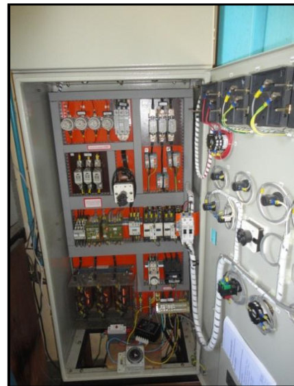
Figura 17. Vista do quadro de comandos, em perfeito estado de conservação.
