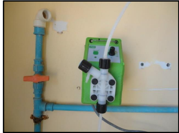
Figura 19. Detalhe da bomba dosadora.
